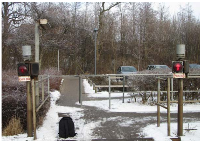
Foto 2 Overgang ved spor 2. Det venstre signal havde defekt pære.
