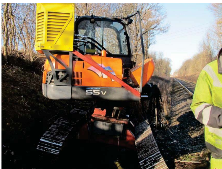
Foto 1 Gravemaskinen efter kollisionen – skrævende over grøften
