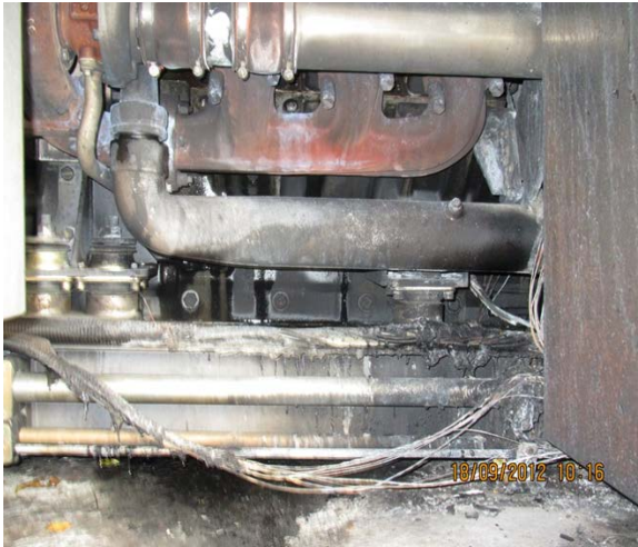
Brandskader motormodul B i MFB 5228
