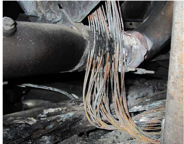
Brændte kabler i motormodul B i MFB 5228
