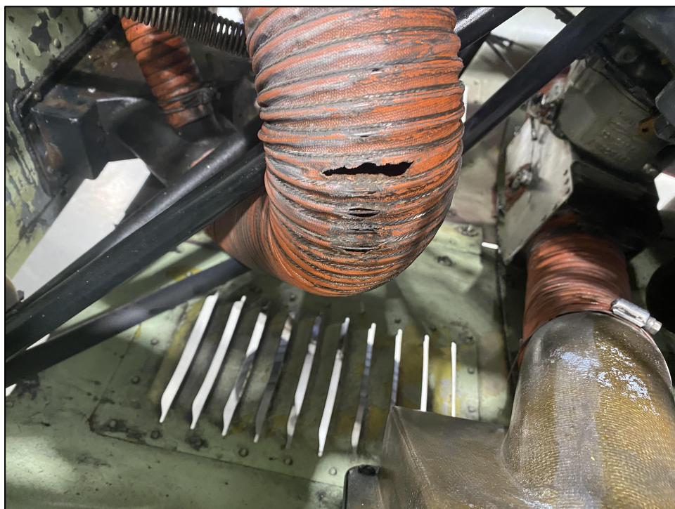
Foto 4. Revner i luftslangen til kabine- og frontrudevarme.
