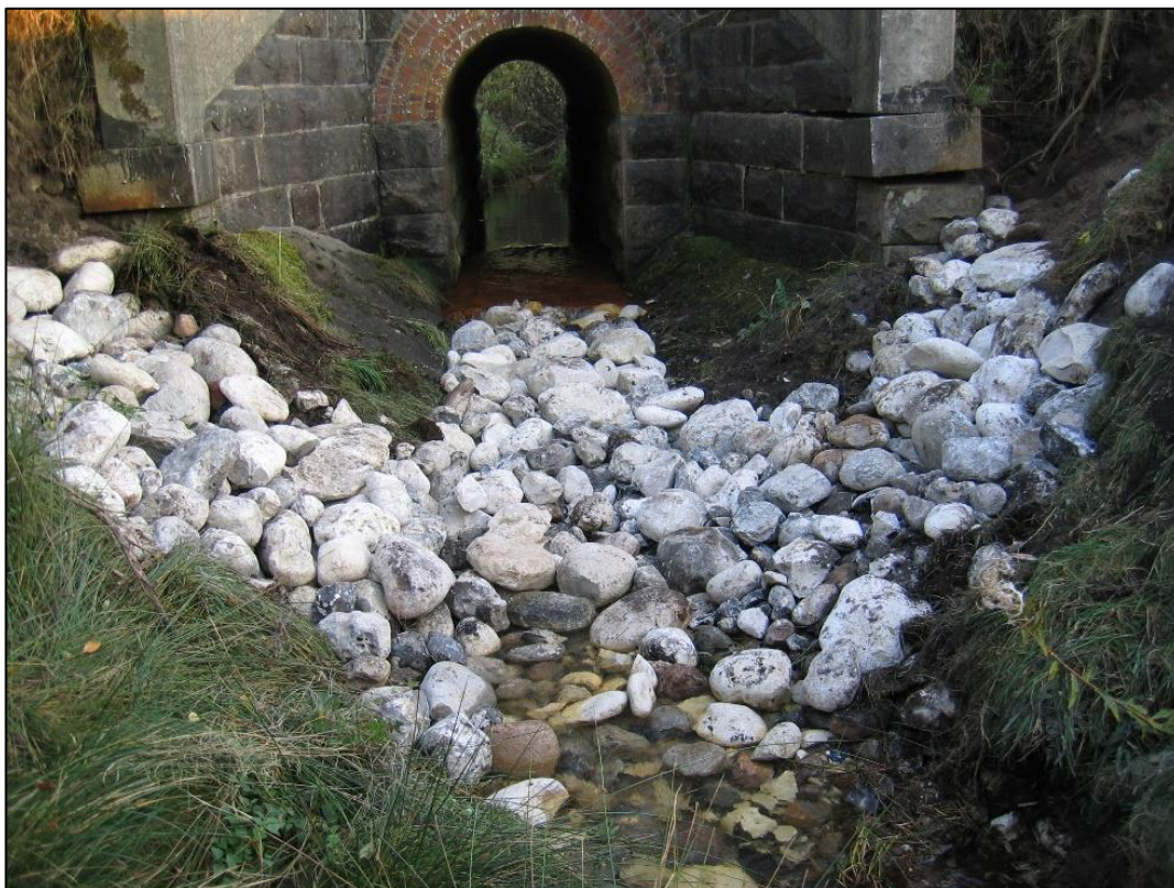
Foto 6. D. 12-10-2005. Udløbssiden af vandløbsbroen. Reparation af vandløbsbund og brinker med marksten. Sætningskade på vestlige fløjmur. Kilde: Privat foto.
