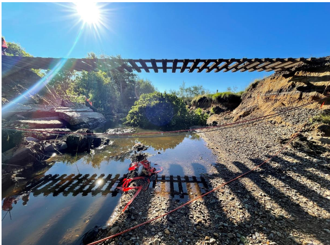
Foto 4. Skade på vandløbsbro og banedæmning. Kilde: Herning Kommune.
