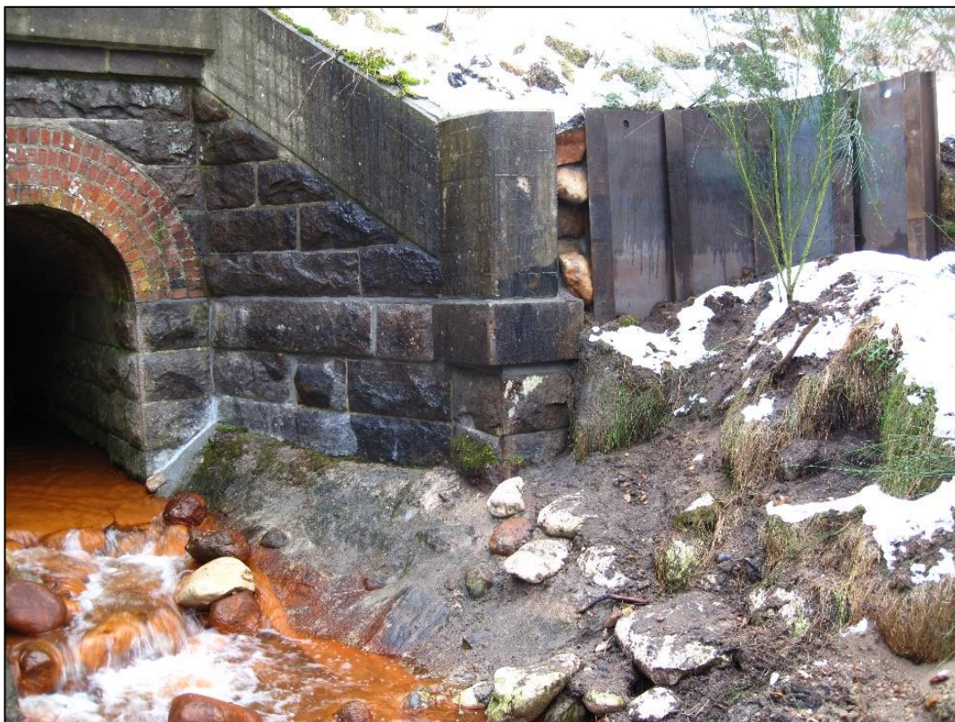
Foto 8. D. 16-02-2009. Udløbssiden af vandløbsbroen. Dæmningen omkring vandløbsbroens udløb forstærket med spuns og reparerede fuger i vestlige fløjmur. Kilde: Privat foto.
