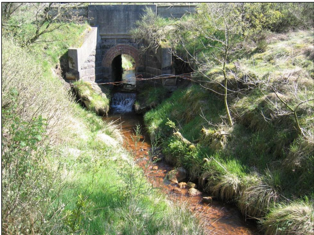
Foto 5. D. 12-05-2005. Udløbssiden af vandløbsbroen. Manglende materiale i bunden af vandløbet ved udløbet, og i brinken ved begge fløjmur. Kilde: Privat foto.
