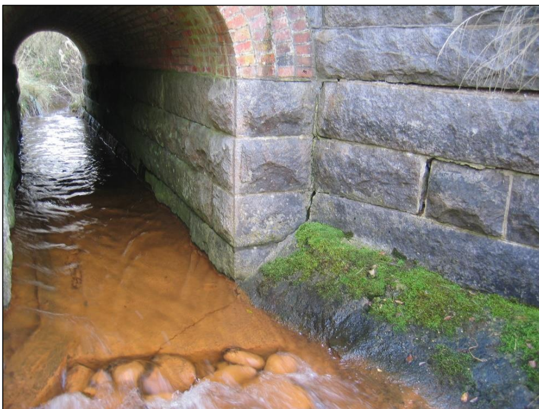
Foto 7. D. 15-11-2008. Udløbssiden af vandløbsbroen. Sætningskade på vestlige fløjmur. Kilde: Privat foto.
